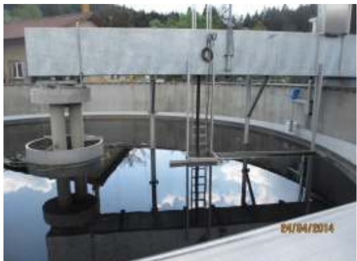
Neues Nachklärbecken (Bild LRA)
