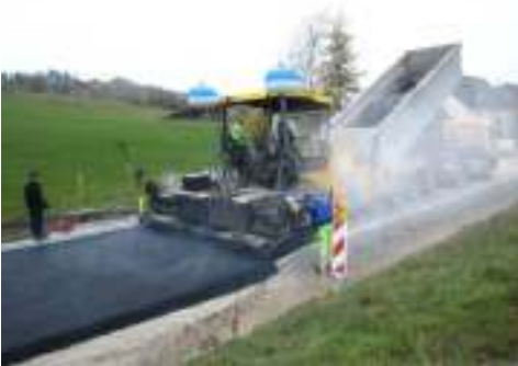
Einbau der Asphalttragschicht auf der Kreisstraße K 2627 bei Unterfischach. Asphaltfertiger mit Beschickerfahrzeug.
